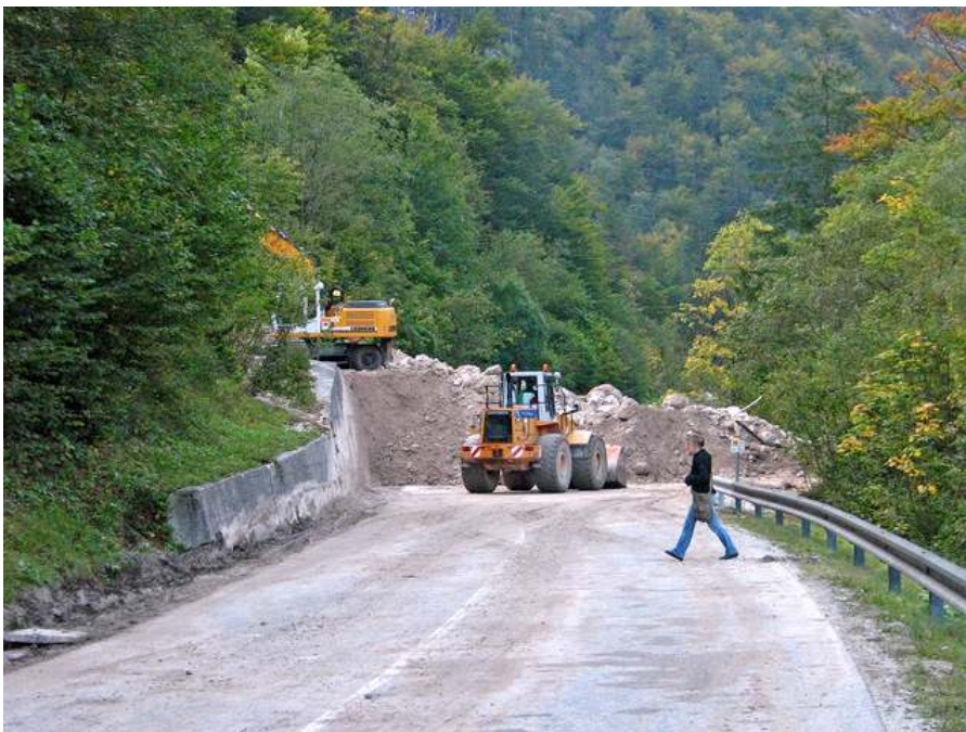
Slika 1: Hudourniški material na cesti v Soteski po neurju septembra 2007 (foto: Aleš Zdešar)
