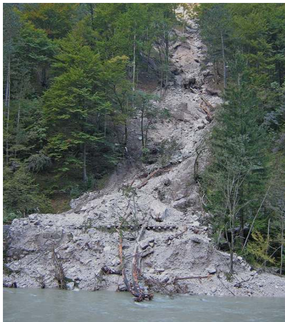
Slika 2: Hudourniški tok je poškodoval železnico v Soteski leta 2007 (Fotografija Aleš Zdešar)
