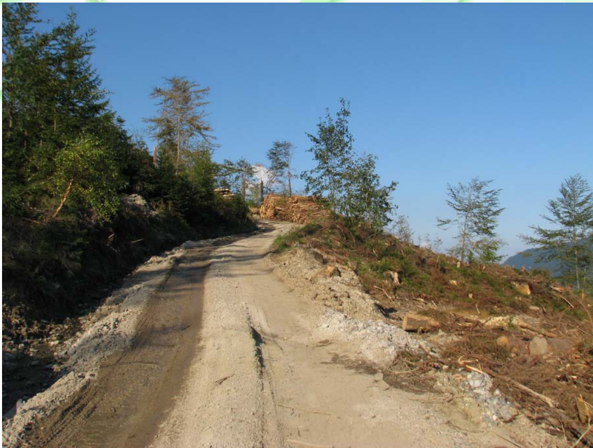
Sekundarne poškodbe gozdnih cest (foto: Igor Solar)
